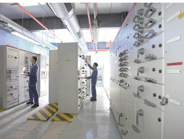
Figur 14: Lågspänningsställverk. Källa: ABB
